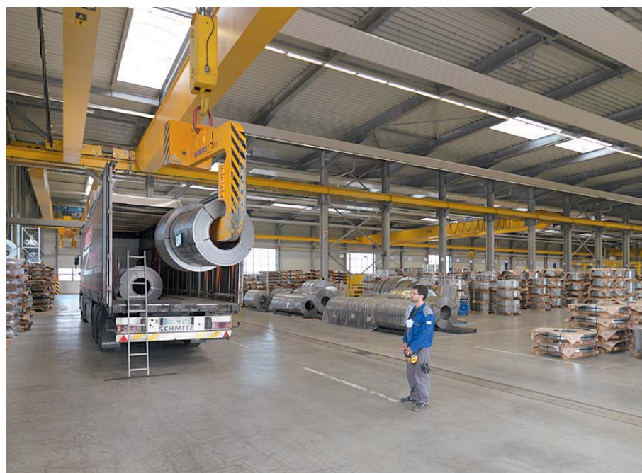
Halle 13: Zwei Krananlagen mit C-Haken werden zum Handling der bearbeiteten Coils eingesetzt
