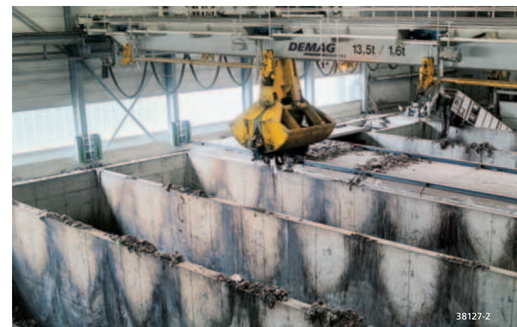
Технологические краны Demag в автоматическом режиме наполняют отходами резервуары для компостирования в мусороперерабатывающей установке
