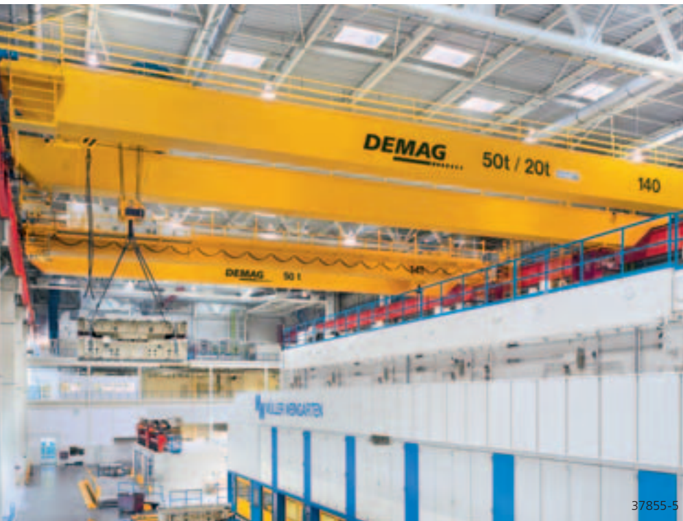
Автомобильная промышленность: замена инструментов на прессо- вой установке с помощью техно- логических кранов Demag.
