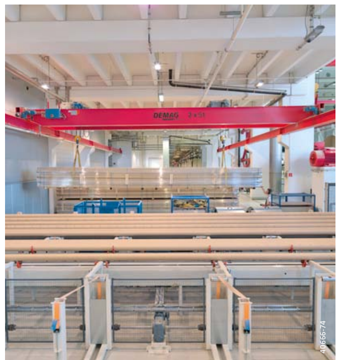
Demag Zweiträger-Laufkran mit zwei Hubwerken übernehmen das Handling von Hülsen-Paketen.
